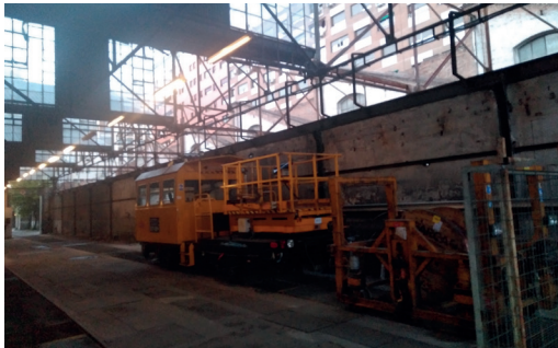
DT201 de Línea Aérea (Dresina Torre) y carro porta bobinas (CB) en servicio hasta junio de 2018 con zapatas de amianto. Nave de dresinas en Cuatro Caminos con techos de fibrocemento en descomposición.
